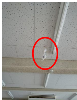
天井に設置したロガー （以下、天井ロガー）
